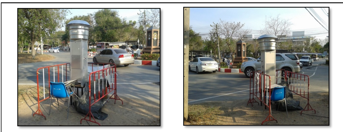
ภาพ ข-7 การติดตั้งเครื่องวัดน้ำประปาในสถานที่ 3: บริเวณหน้าคณะวิทยาศาสตร์ และเทคโนโลยี (ฝั่งอาคาร 10)
