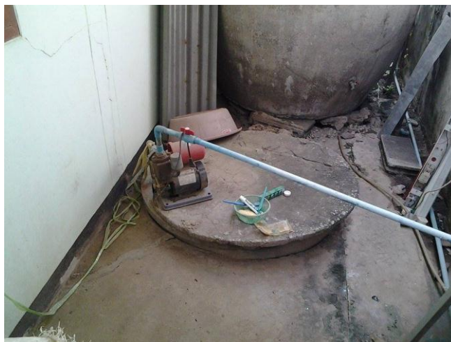
รูปที่ จ-2 รูปบ่อน้ำบาดาลเจาะเองที่ 88 หมู่ 20 บ้านคุยเท็ก ต.เขวาสินรินทร์
