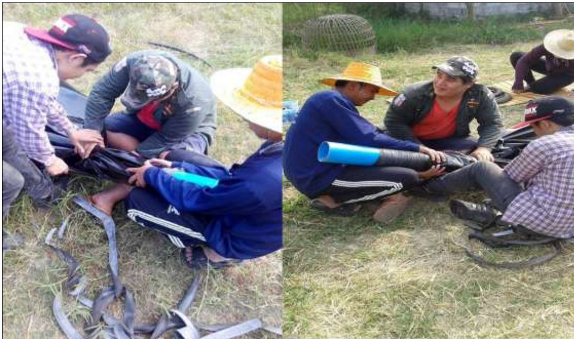
ภาพที่ ก-4 มัดถุงพลาสติก LDPE (Low Density Polyethylene) กับท่อ PVC (Polyvinyl Chloride)
